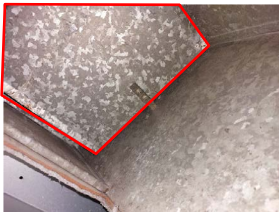
進風口風閘關閉
