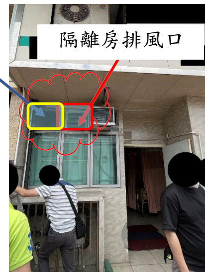
排風口太接近進風口
