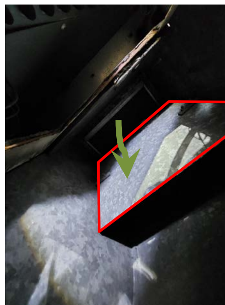
進風口風閘打開
